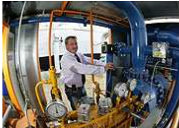
Die Gemeinde Neustadt-Glewe nutzt Energie aus Erdwärme: Werksleiter Mario Hielscher überprüft die Turbine im ersten geothermischen Kraftwerk Deutschlands, das auch Strom produziert. Foto: Röhrbein
